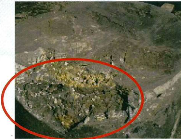
攪拌不足による断面欠損
